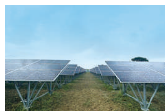
オフサイトフィジカルコーポレートPPA太陽光発電設備
